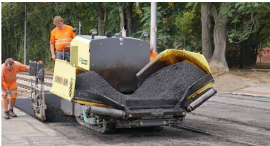
Kompaktní finišer Ammann AFT 300-2 byl schopen i dokončovacích prací na vnější straně každé koleje
